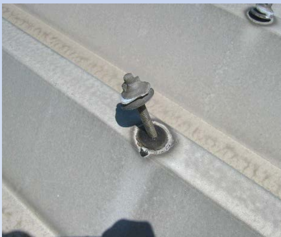
断熱接合部の破断したボルト
