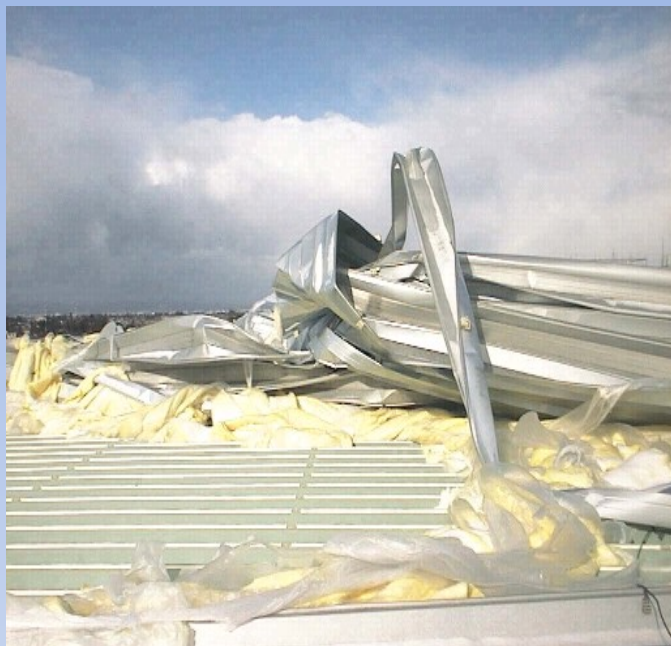
上折板がめくれた状況
