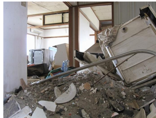
内部破壊（ 閑上 ）
