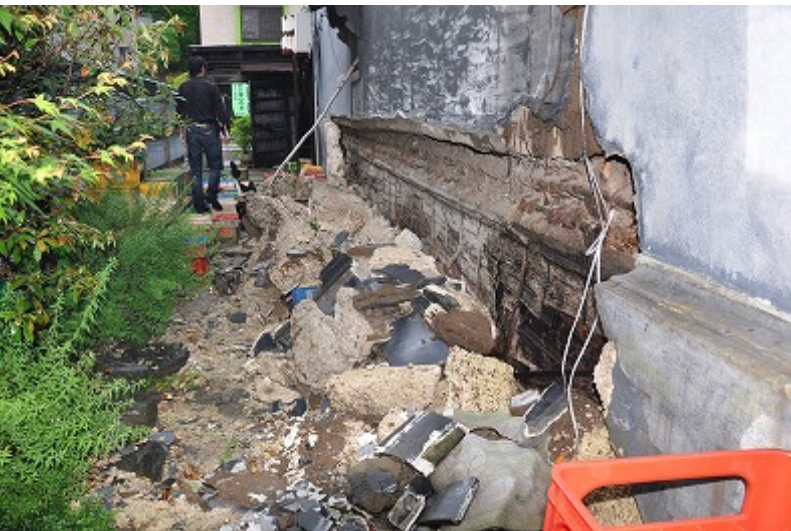
典型的な土壁の被害
