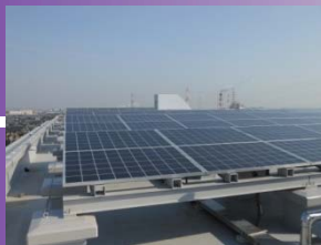
太陽光パネル架台
