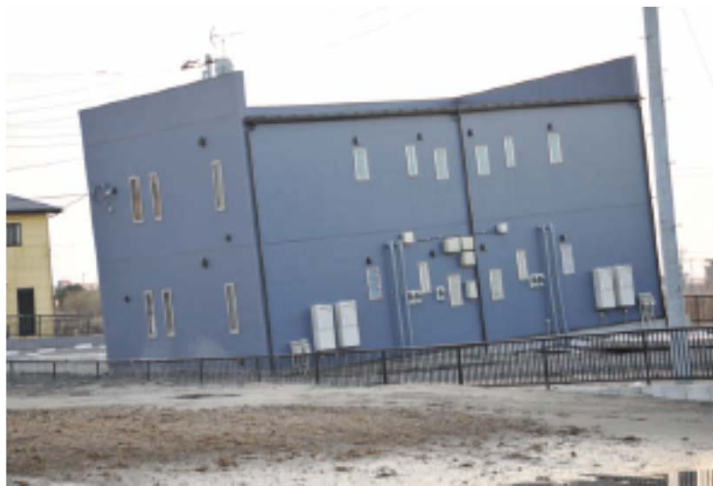
戸建て住宅の液状化被害状況
