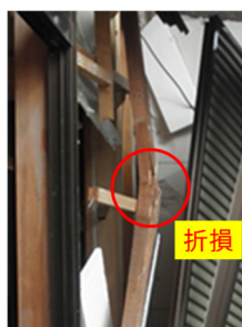
写真 5. 筋かいの折損
