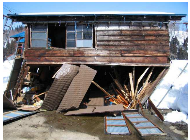
写真12 積雪に寄りかかり倒壊を免れた倉庫
