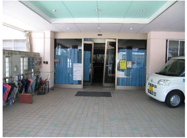
写真 14 RC 建物の自動扉被害
