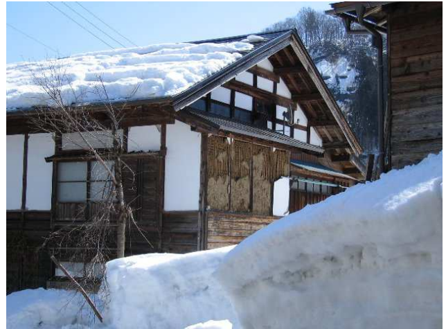
写真 16 土壁外壁の落下
