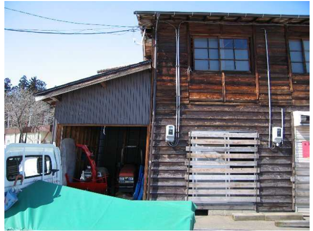
写真 20 残留傾斜した建物
