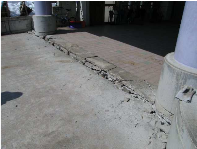
写真 15 RC 建物基礎のひび割れ
