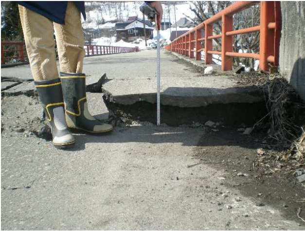
写真 25 橋梁に生じた段差(20cm)
