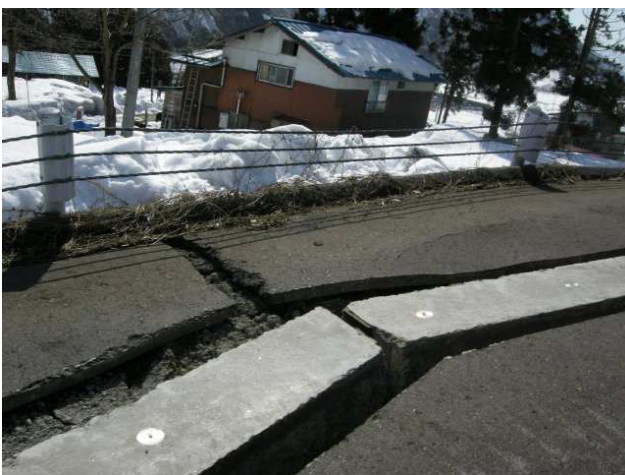
写真 35 融雪道路の被害
