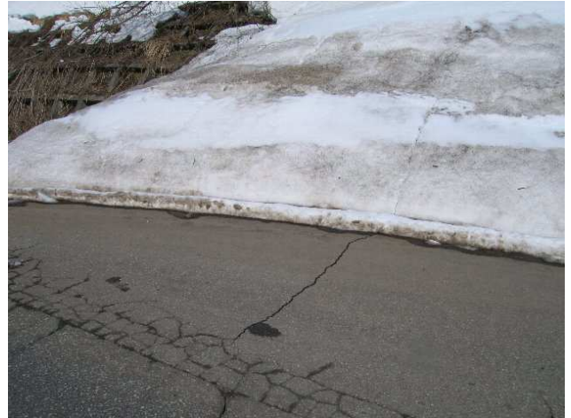
写真8 橋北東アスファルトのひび割れ
