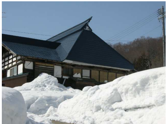
写真 34 建物の外壁被害
