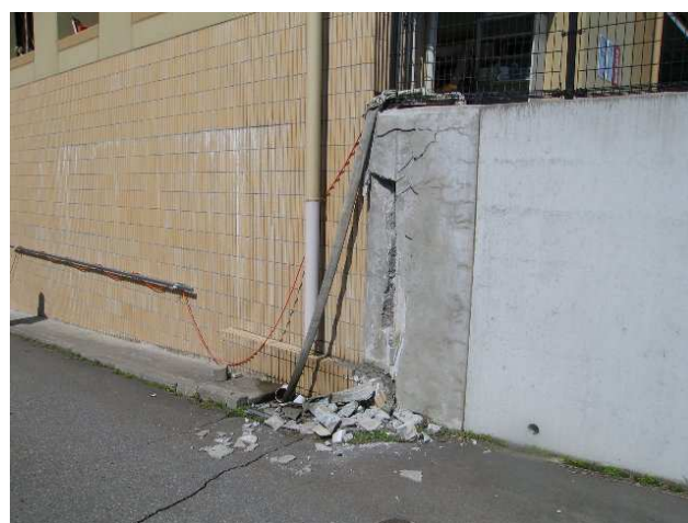
写真6 栄村役場裏面の被害
