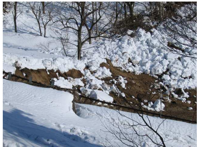
写真 28 JR 飯山線の線路被害
