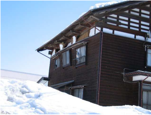
写真 13 2階柱ほぞの抜け被害
