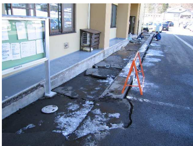
写真5 栄村役場正面の地盤被害
