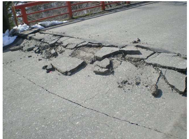
写真 24 橋梁継ぎ目のひび割れ
