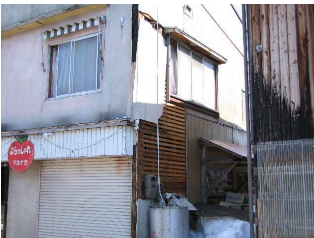
写真11 外壁モルタルの落下
