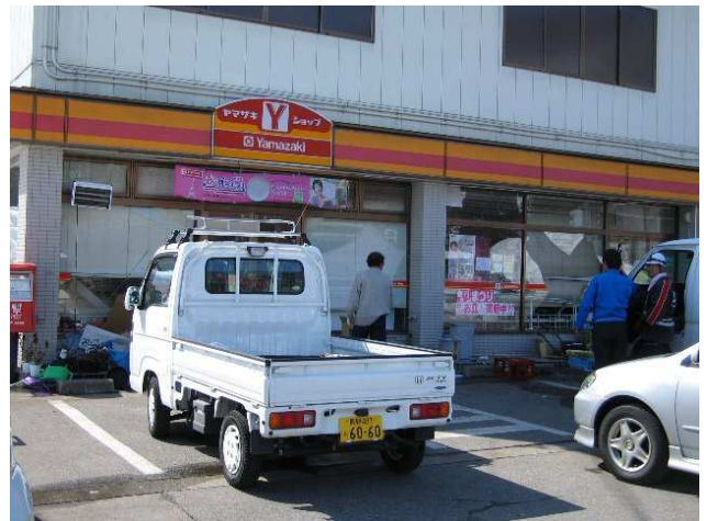
写真 22 窓ガラスの割れ
