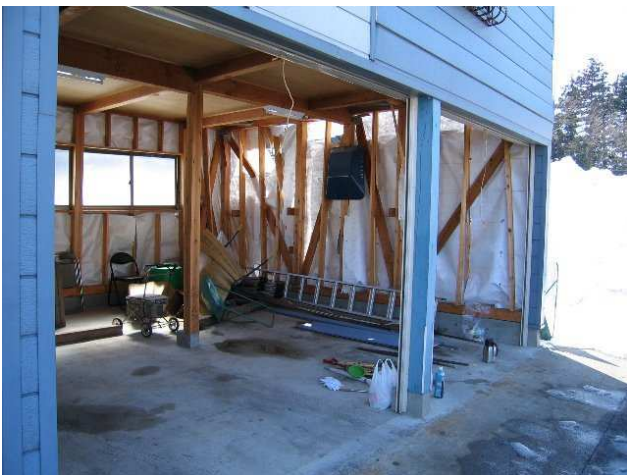
写真 17 筋かいの折損
