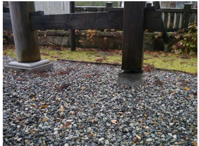
写真 30 鳥居：控え柱の浮き上がり
