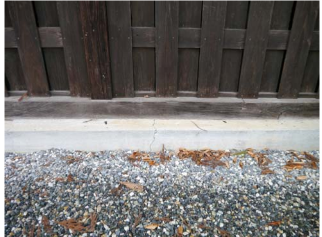
写真 28 本殿：基礎の亀裂
