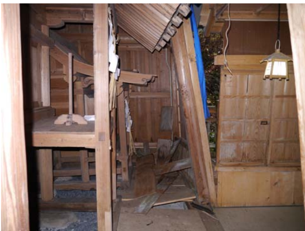
写真9 本殿覆屋：入口の柱の傾斜
