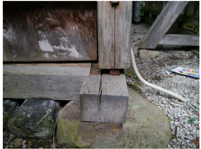
写真6 本殿覆屋：柱脚の土台からの抜け出し
