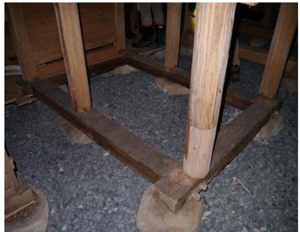
写真14 神明社本殿：柱脚の移動
