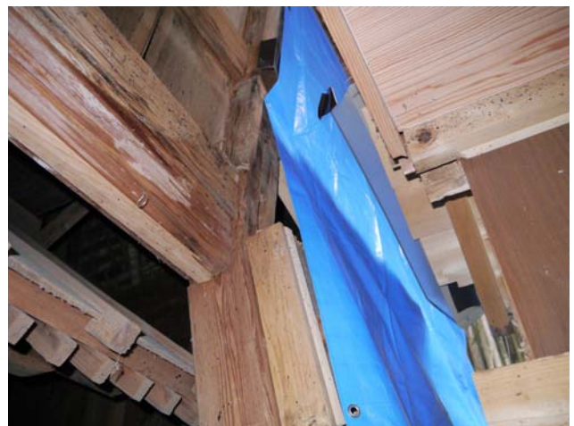
写真10 写真9の柱の折損
