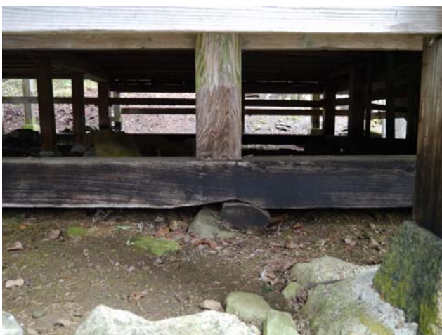
写真 19 本殿：土台と組石とのずれ
