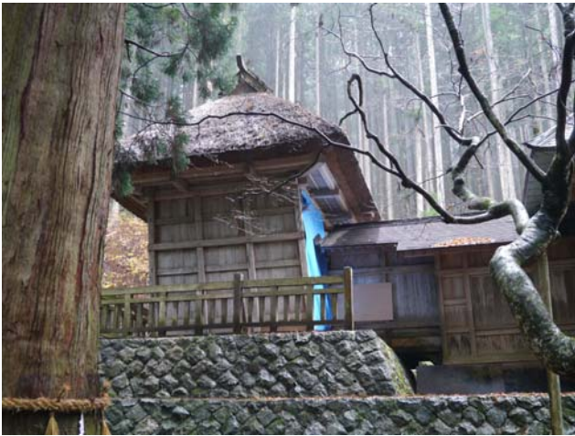
写真5 大きく傾斜した本殿の覆屋
