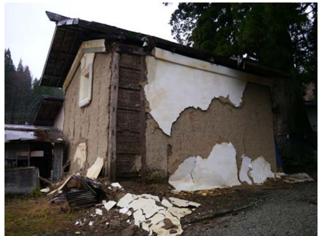
写真 26 入口にある土蔵の被害
