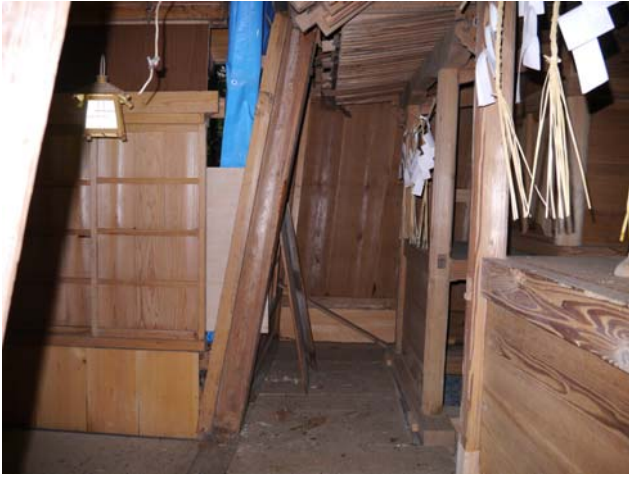
写真11 本殿覆屋：入口の柱の傾斜
