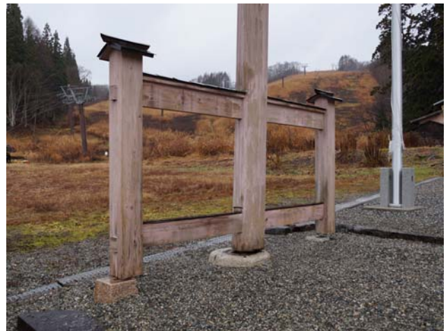
写真 24 鳥居：柱脚の浮き上がりと移動
