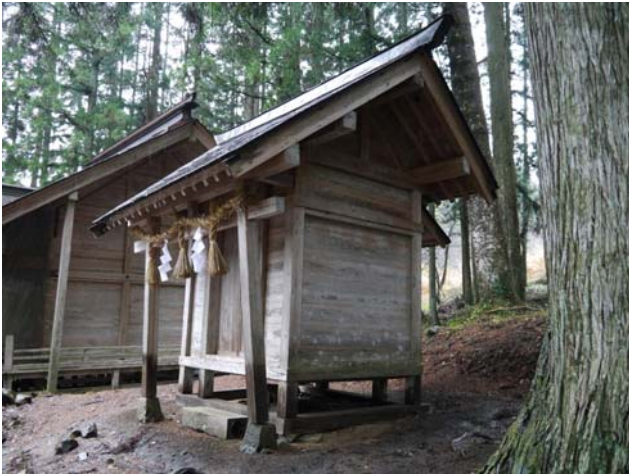
写真 21 本殿北側の社：全体が滑動している
