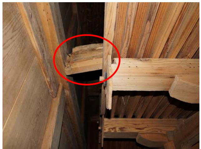
写真8 諏訪社本殿の屋根に落下した長押
