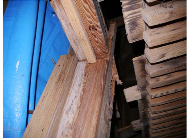
写真12 写真11の柱の折損
