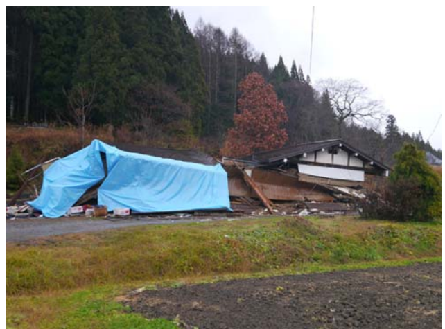
写真 40 倒壊した建物
