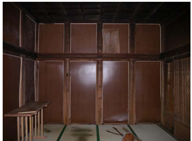
写真4 拝殿：内部の化粧合板のゆがみ
