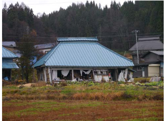
写真 36 大きく傾斜した民家
