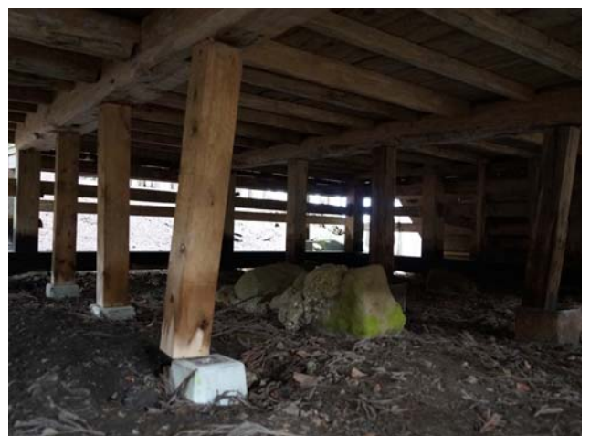
写真 20 本殿：束が組石から外れている
