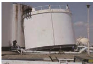
写真1 タンクの浮き上がり 1)
