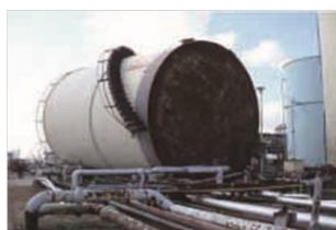
写真2 タンクの転倒 1)
