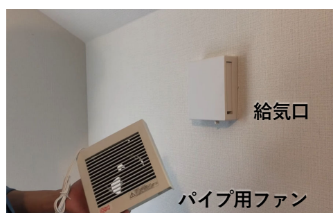
図13 給気口とパイプ用ファン
