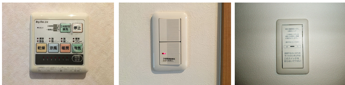
図 1 24 時間換気システムのスイッチの例 (左：戸建住宅の浴室、中：戸建住宅の 2 階のトイレ、右：集合住宅)
