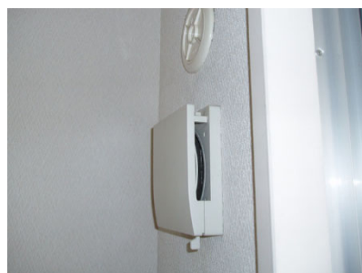
図 2 室内側からみた給気口の例
