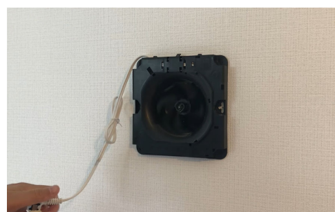
図14 設置後カバーを外したファン
