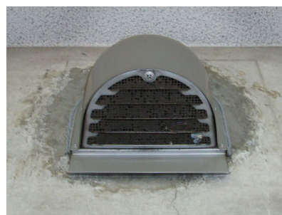
図 7 ダクトフードの防虫網
