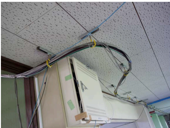
職員室に引き込まれるケーブル
