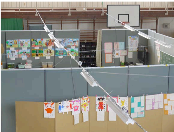
ワイヤーに吊られた蛍光灯
