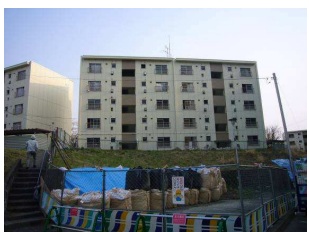
(a) 建物外観[手前側に傾斜]
