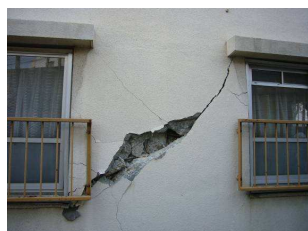
(b) 1階耐力壁の被害
