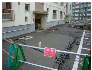
(b) 敷地の地盤変状
