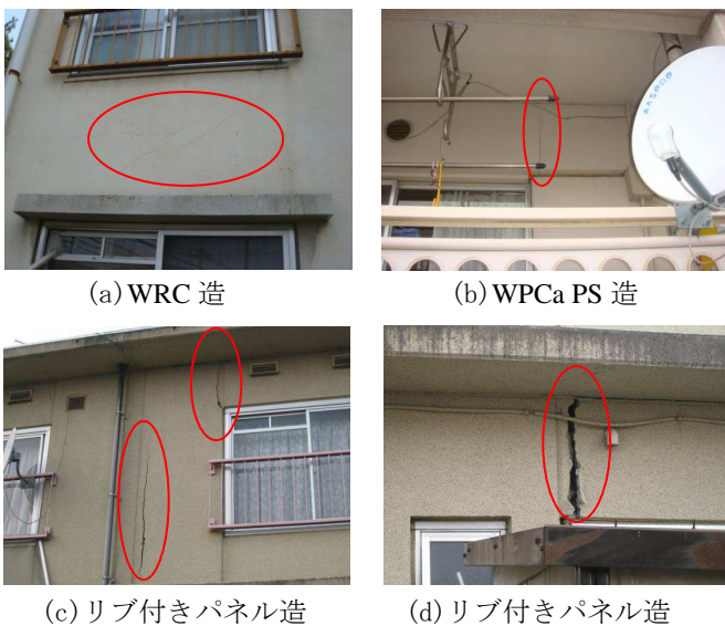
図1 各種RC系壁式構造物の壁梁および接合部の損傷
