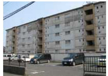
写真2 被災事例1の北面外観
