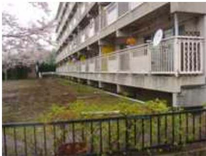
写真4 東側(写真右側)への沈下
