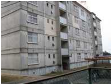
写真5 被災事例2の北面外観
