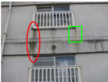
写真6 上下階開口間のひび割れ
