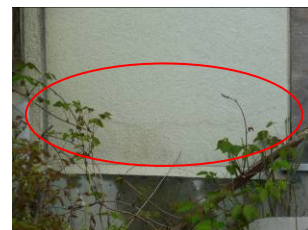
写真3 耐力壁脚部の 曲げひび割れ
