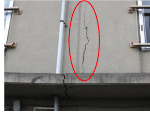
写真6 耐力壁-柱型鉛直接合部ひび割れ
