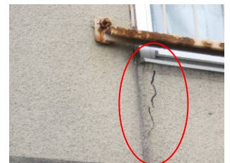
写真2 耐力壁-腰壁 接合部周辺ひび割れ
