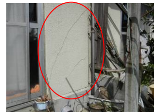
写真4 耐力壁のせん断 ひび割れ
