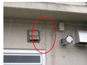
写真1 耐力壁-垂れ壁 接合部周辺ひび割れ
