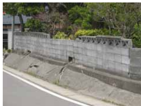
写真 5.1.2.18 調査番号 門10 かさ木が一部落下した ブロック塀
