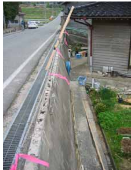
写真 4.2.1 敷地側に転倒したコンクリート擁壁上のブロック塀
