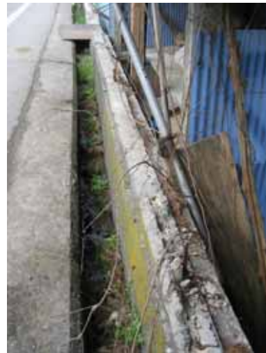
写真5.1.2.5 調査番号 門6 布基礎上から倒壊した 老朽化の激しいブロック塀
