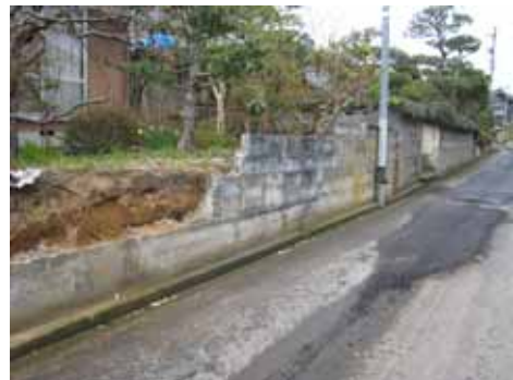
写真 5.1.2.2 調査番号 門 2 基礎上から道路側へ倒壊した ブロック塀
