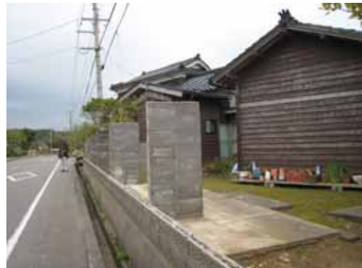
写真 5.1.3.6 調査番号 志7 控壁を残し道路側へ倒壊した ブロック塀
