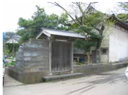
写真5.1.2.6 調査番号 門8 基礎上から倒壊したブロック塀
