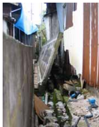
写真 5.1.2.9 調査番号 門 13 布基礎上から倒壊した ブロック塀
