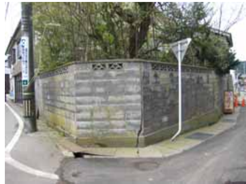
写真 5.1.2.16 調査番号 門7 隅角部の一部が縦破断した ブロック塀
