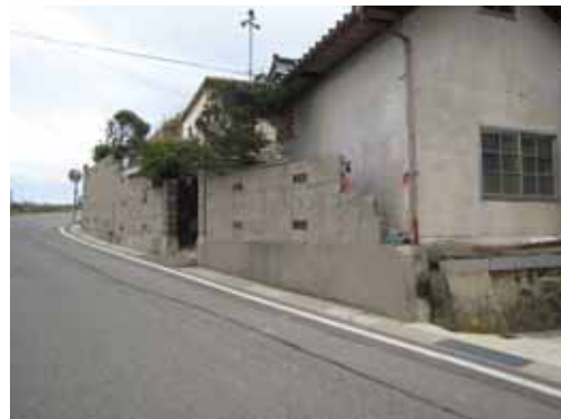
写真 5.1.3.2 調査番号 志 2 壁体の一部が斜め破断した ブロック塀
