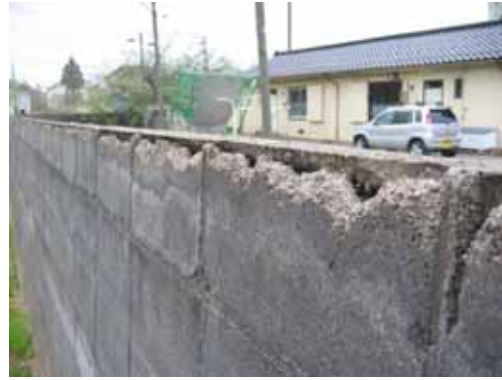
写真5.1.3.8 調査番号 穴2 かさ木が落下したブロック塀
