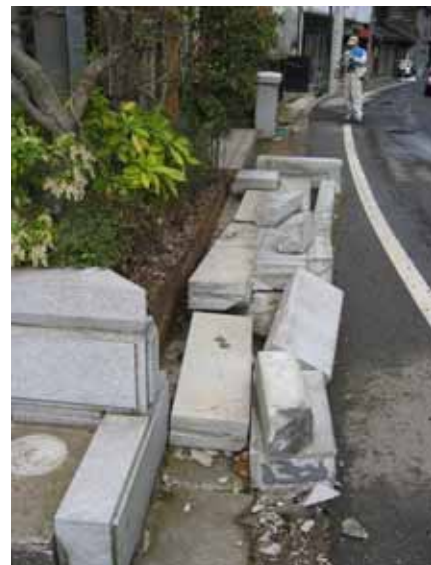
写真 4.3.1 石塀の崩壊状況
