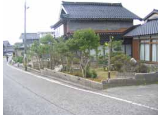
写真 5.1.3.5 調査番号 志5 壁体下部 1 段を残し倒壊した ブロック塀
