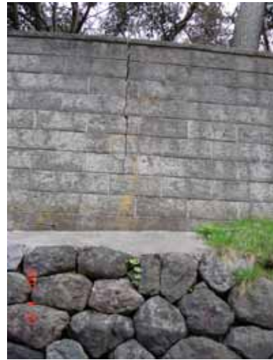
写真 5.1.1.12 調査番号 河 17 壁面に縦ひび割れが生じた ブロック塀
