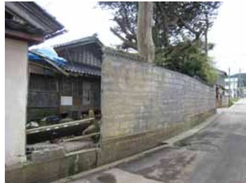
写真 5.1.2.14 調査番号 門9 部分的に破断・倒壊した ブロック塀
