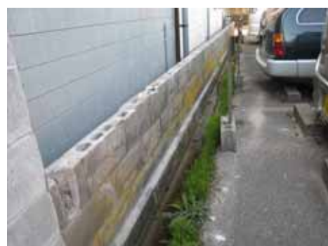
写真 5.1.1.3 調査番号 河 10 上部 5 段が破壊・落下した ブロック塀
