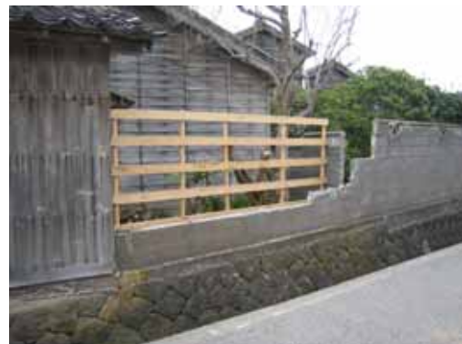
写真 5.1.2.12 調査番号 門 18 壁体下部 2 段より倒壊した ブロック塀
