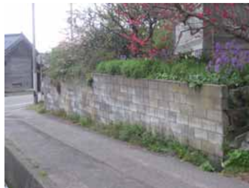
写真5.1.3.9 調査番号 志6 ひび割れ・傾斜が生じた ブロック塀
