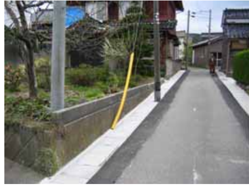
写真 5.1.2.10 調査番号 門 14 布基礎上 1 段から倒壊した ブロック塀
