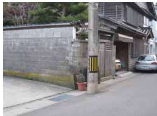
写真 5.1.1.17 調査番号 河 16 わずかに傾斜したブロック塀
