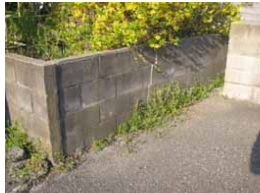
写真 5.1.1.7 調査番号 河 12 塀上端より基礎まで壁面に 縦亀裂が生じたブロック塀
