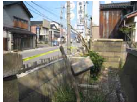
写真 5.1.1.2 調査番号 河 8 上部 2 段が破壊・落下した 化粧ブロック塀
