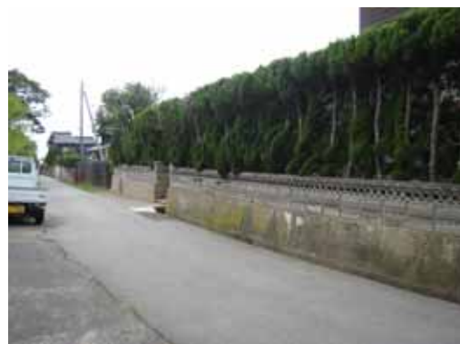
写真 5.1.3.7 調査番号 志8 ぐらつき・傾斜を生じた ブロック塀
