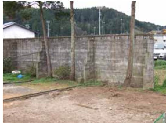
写真 4.4.1 仕上げが無く壁面がやや変色し老朽化が進行中の補強ブロック塀
