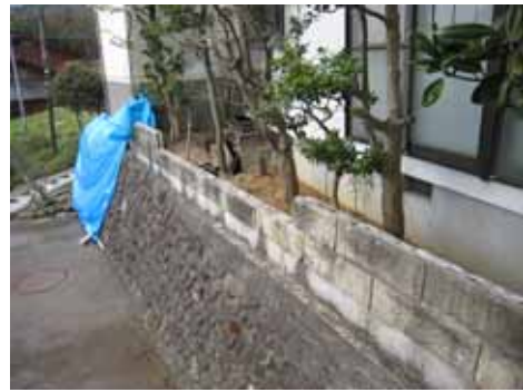
写真5.1.2.4 調査番号 門5 壁体上部1～2段が転倒・落下した 化粧ブロック塀
