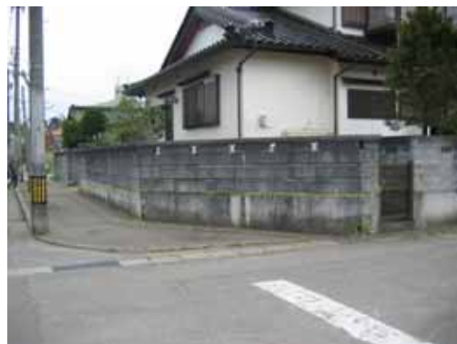
写真5.1.3.10 調査番号 穴1 軽微なひび割れ・傾斜が生じた 化粧ブロック塀
