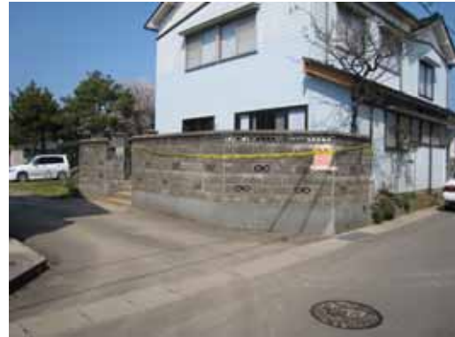
写真 5.1.1.15 調査番号 河 5 壁面にひび割れが発生した ブロック塀
