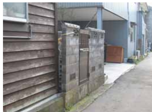
写真 5.1.1.11 調査番号 河 7 傾斜が軽微なブロック塀
