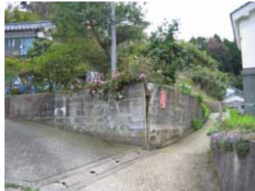
写真 5.1.2.13 調査番号 門4 隅角部が縦破断した ブロック塀
