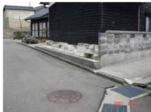
写真5.2.2 調査番号 門2 布基礎上から倒壊した大谷石塀
