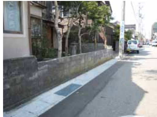
写真 5.1.1.10 調査番号 河 4 壁体の上一段が落下したブロック塀
