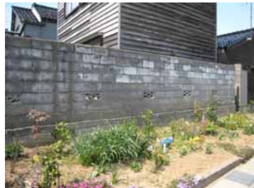
写真 5.1.1.13 調査番号 河 1 わずかに傾斜したブロック塀
