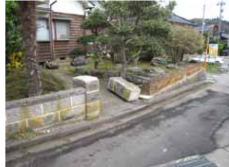
写真 5.1.2.1 調査番号 門 1 道路側へ倒壊した 門柱付き化粧ブロック塀
