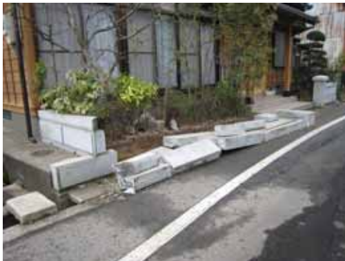
写真5.2.1 調査番号 門1 道路側に投下した御影石塀
