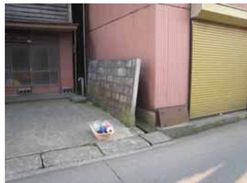
写真 5.1.1.8 調査番号 河 13 大きく傾斜したブロック塀
