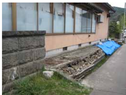
写真 5.1.2.8 調査番号 門 12 基礎上から道路側へ倒壊した 化粧ブロック塀
