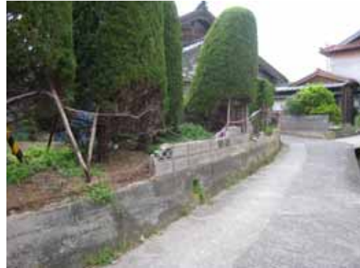
写真 5.1.3.1 調査番号 志 1 布基礎上端から倒壊した ブロック塀
