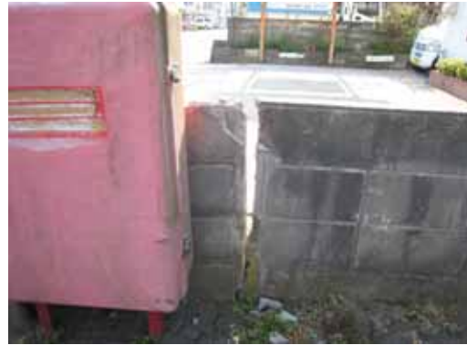
写真 5.1.1.6 調査番号 河 9 縦目地が塀上端より基礎まで 破断したブロック塀
