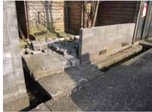
写真 5.1.1.4 調査番号 河 11 上部 5 段が破壊・落下した ブロック塀
