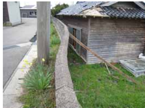
写真 5.1.2.11 調査番号 門 17 傾斜の著しいブロック塀
