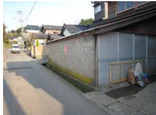
写真 5.1.1.16 調査番号 河 14 ひび割れが軽微なブロック塀
