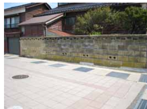
写真 5.1.1.14 調査番号 河 2 軽微なひび割れが発生した ブロック塀
