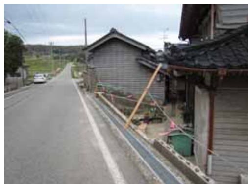
写真 5.1.3.3 調査番号 志 3 擁壁基礎上端から倒壊した ブロック塀
