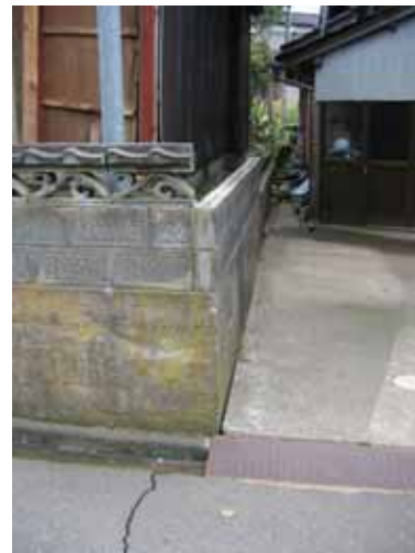
写真 5.1.2.17 調査番号 門15 かさ木と上部1段が落下した ブロック塀
