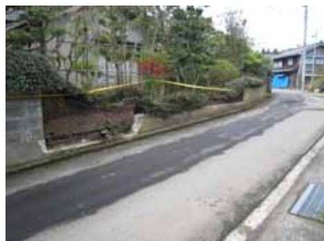
写真 5.1.2.3 調査番号 門 3 基礎上から道路側へ倒壊した ブロック塀
