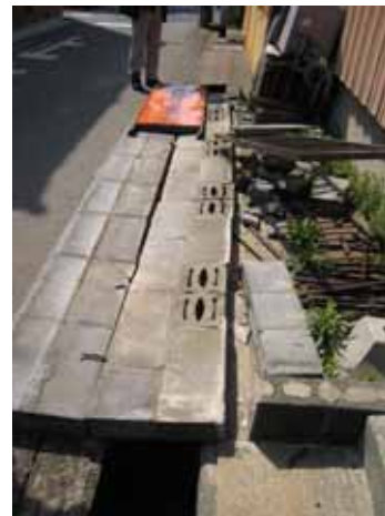
写真 5.1.1.1 調査番号 河 3 道路側へ倒壊した 組込フェンス塀
