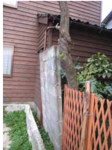
写真 5.1.1.9 調査番号 河 15 傾斜の大きなブロック塀
