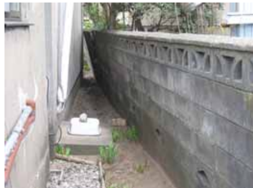
写真 5.1.2.15 調査番号 門16 一部傾斜の大きなブロック塀
