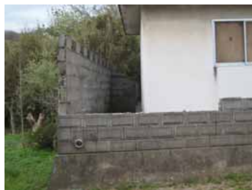
写真 5.1.3.4 調査番号 志4 上部6段が倒壊・落下した ブロック塀
