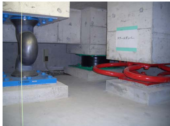
写真2.10 G建物の免震部材
