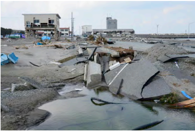
砂浜を掘り込んだ漁港の作業場が液状化により路盤が崩壊した。 (三沢市三沢漁港)
