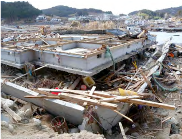
低地の建物基礎の被災状況
