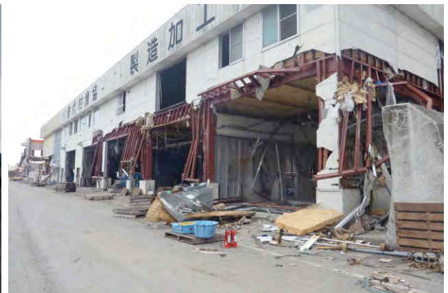
1階が全壊した鉄骨造の加工場。木造の場合は、土台から流失が多い。(普代村大田名部 普代漁港)
