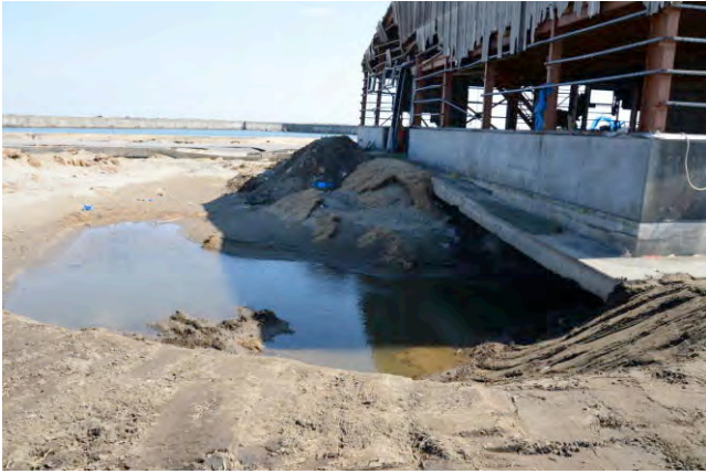
地盤の液状化と津波により表土が流出し、基礎が露出した魚市場。
