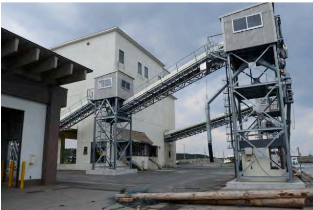
鉄筋コンクリート造の積み込みタワー 開口部からの浸水被害が主である。
