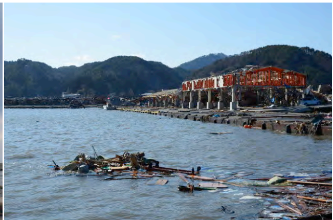
鉄骨造の魚市場。外壁・屋根が飛ばされ、鉄骨柱根元にコンクリートを巻いている。
