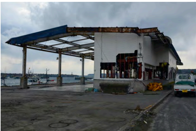
津波で側壁と屋根が飛ばされた鉄骨造の魚市場。 コンクリートで根巻きした柱。 (洋野町種市 種市漁港)
