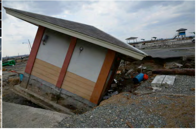
液状化と土壌流出により、沈下した建物。給排水設備が損壊している。
