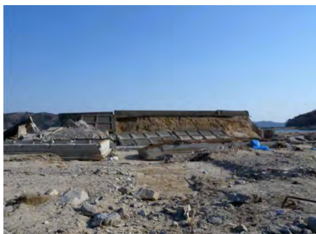
被災した船越湾沿いの防潮堤
