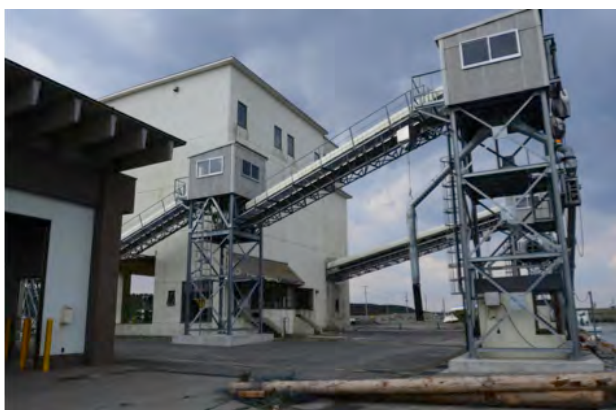
鉄筋コンクリート造の漁港施設は開口部が破損したが構造的被害は殆どない。
