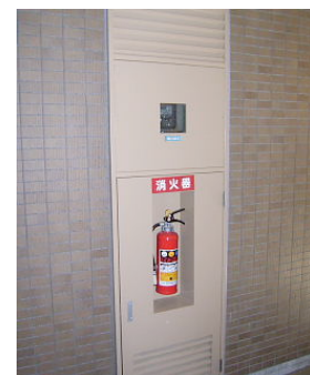
消火器の設置場所を覚えていますか？
