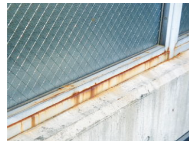
鉄部は適切なメンテナンスを行わないと劣化の進行が早い
