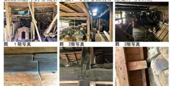
梁が腐れている 梁が腐れている 渡りあごの写真
