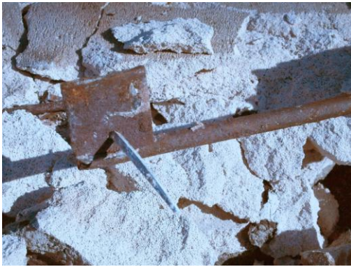
写真 11 落下したALC版外壁の取りつけ 部分
