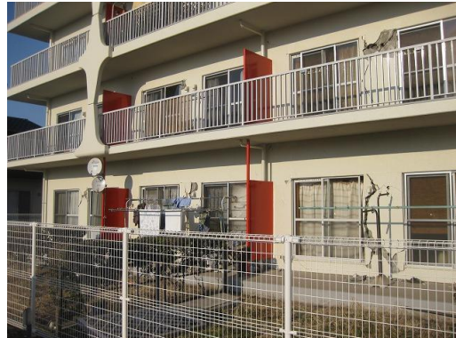
写真17 非構造壁のせん断破壊
