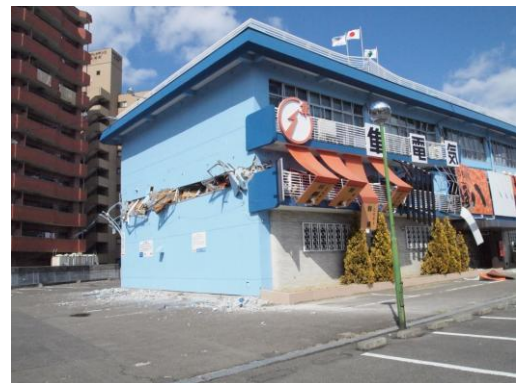
写真7 2階部分の倒壊
