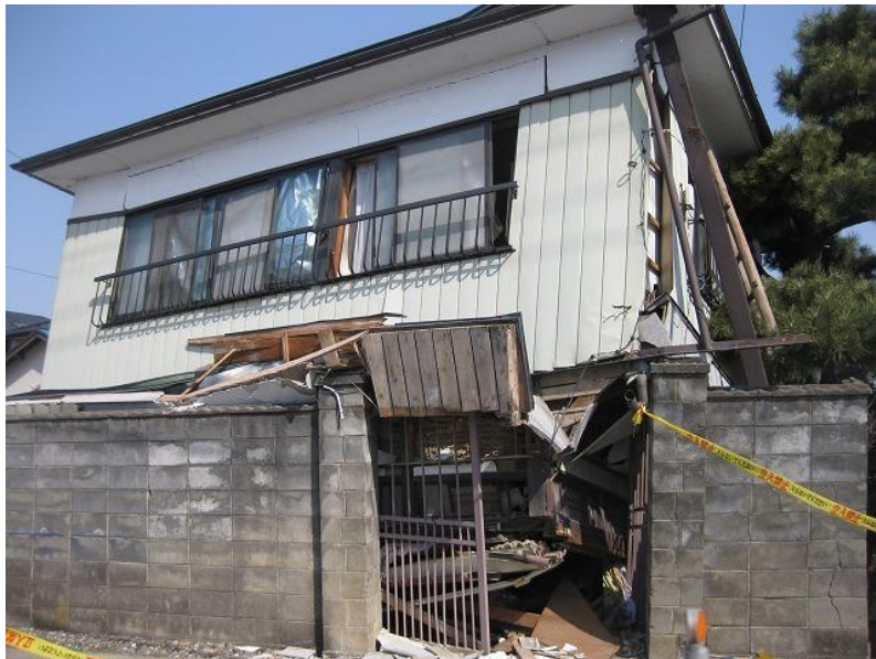
写真3 2階建て木造住宅の倒壊
