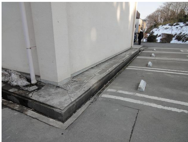
写真 12 岩出山高校校舎（RC 造 3 階建て）の基礎と犬走り境界部のひび割れ
