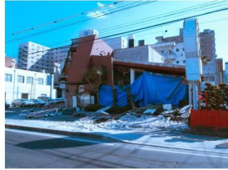
写真 10 2階建鉄骨造の屋根材の落下 (大和町5丁目)
