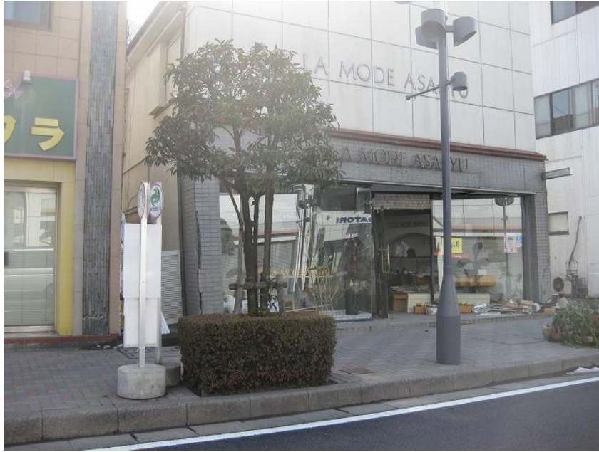
写真 8 2 階建て木造店舗併用住宅の傾斜
