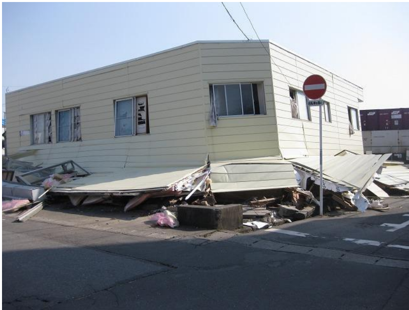
写真 9 2 階建て木造店舗併用住宅の倒壊
