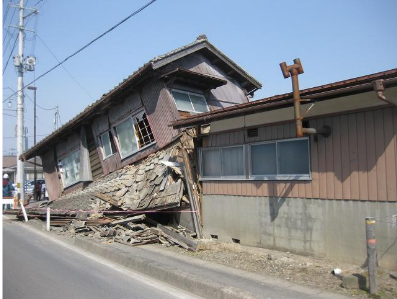
写真2 2階建て木造住宅の倒壊
