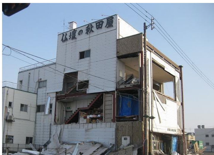
写真 15 加美町中新田地区の S 造 3 階建て店舗（外壁の大規模剥落）
