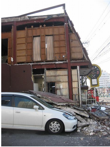
写真 9 2階建鉄骨造の外壁の落下 (大和町5丁目)
