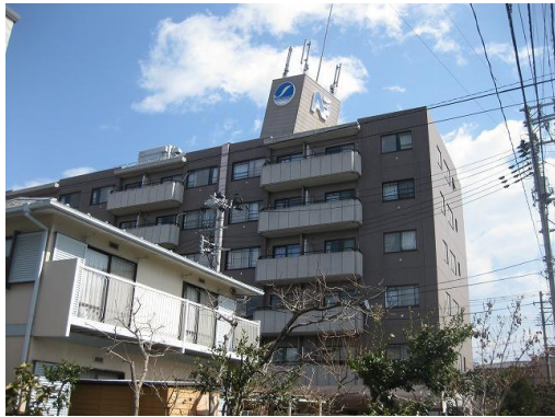
写真5 ペントハウスの被害（若林区成田町）
