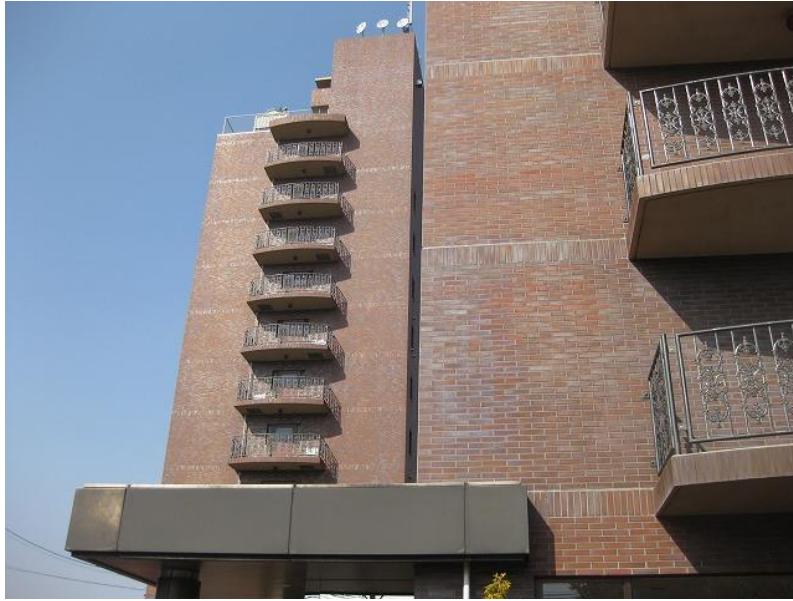
写真 10 11 階建て RC ホテルの傾斜（手前の建物）
