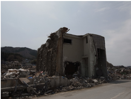
基礎から破壊されて横転する RC 造
