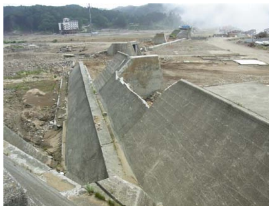
写真 2.7-8 破壊された第二防潮堤
