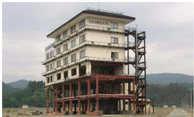
写真 2.7-5 田老観光ホテルの被災状況
