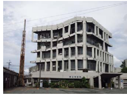
2016年熊本地震で崩壊したRC造建築物
